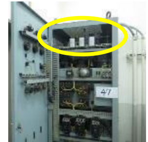
可変周波数電源装置の低圧コンデンサー
