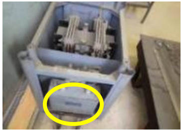
電気溶接機の側面に取り付けられた低圧コンデンサー
