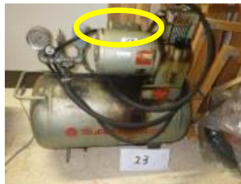
コンプレッサーに取り付けられた低圧コンデンサー
