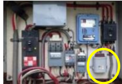
低圧分電盤内の低圧コンデンサー
